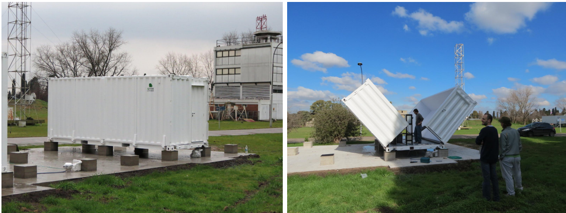
Figura 4.2.14: Vista general del contenedor-domo que alberga al lidar multiángulo.
