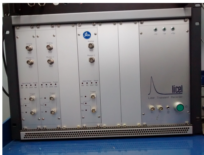
Figura 4.3.4: Vista frontal del rack conteniendo los 3 módulos Licel.
